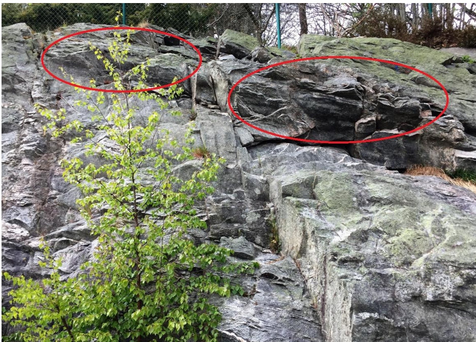
Figur 3. Bergskärning med överhängande block.
