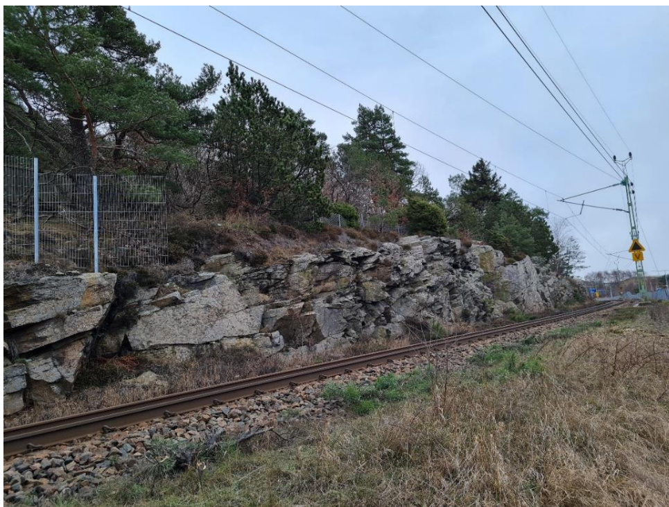
Figur 5. Norra delen av skärningen. Uppsprucket och skivigt berg med måttlig vittringsgrad.
