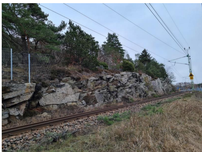
Figur 6 Slutningen från Solgårdsterassen närmast järnvägen.
