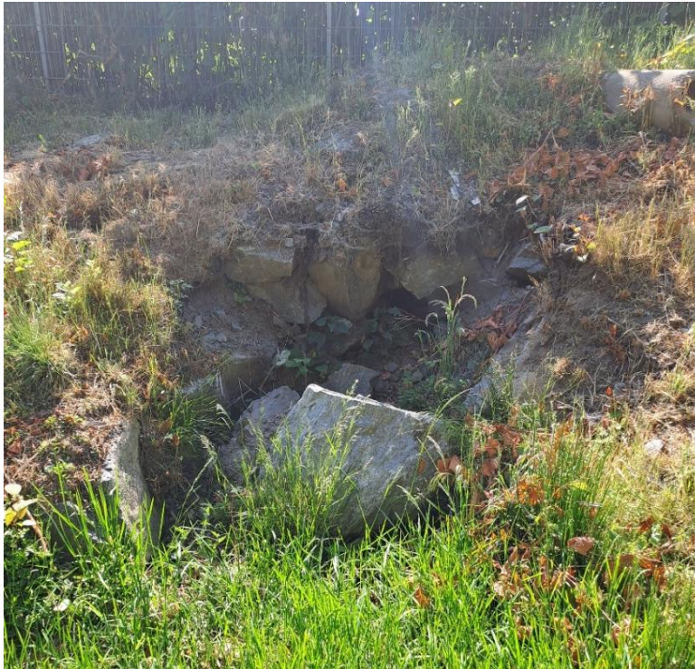
Figur 7 Igenrasad stentrumma under banvallen för avvattning av södra delen av planområdet. Trafikverket är underrättade om tillståndet men nekar till att det skulle vara deras trumma. Driftavdelningen har därför beslutat att gräva fram den.
