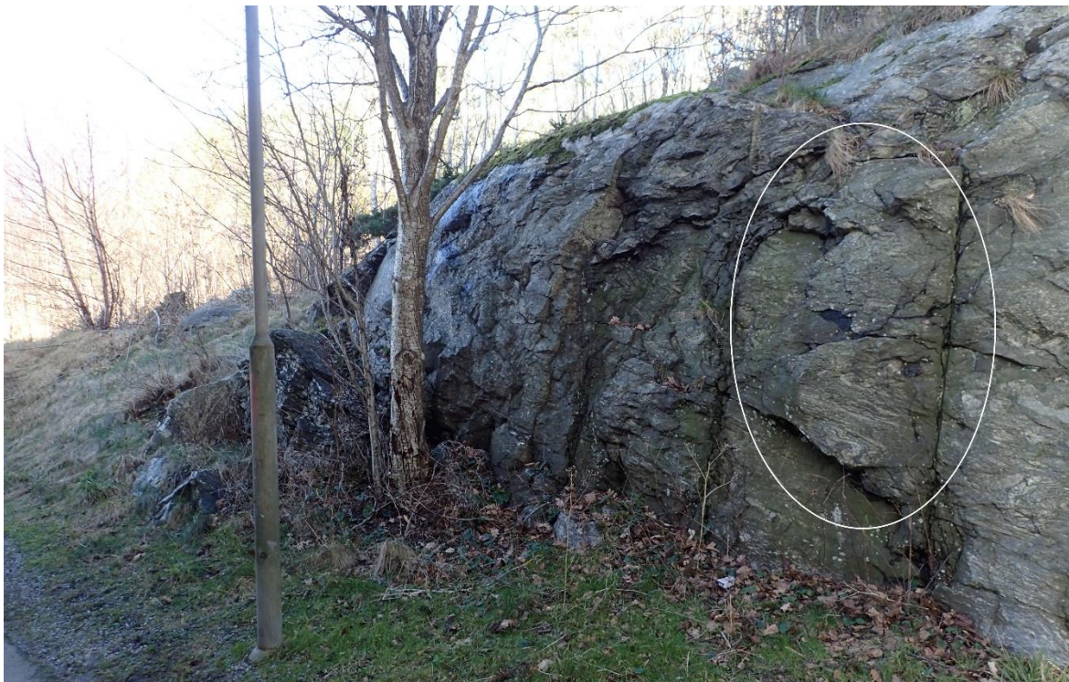
Figur 2. Del av den sprängda bergsläntens strax norr om Bergsvägen 21 som visar läget för potentiellt instabila block (inom vit linje), vy åt nordväst. Bildens läge framgår av Figur 1.
