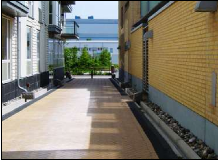
Figur 8. Stuprören ansluter till rännor för avledning av takvatten
